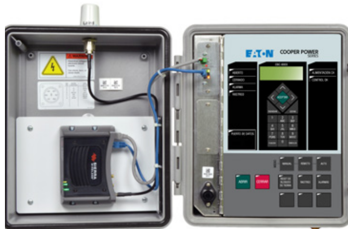
Imagen 7. Control CBC-8000 con módem.
